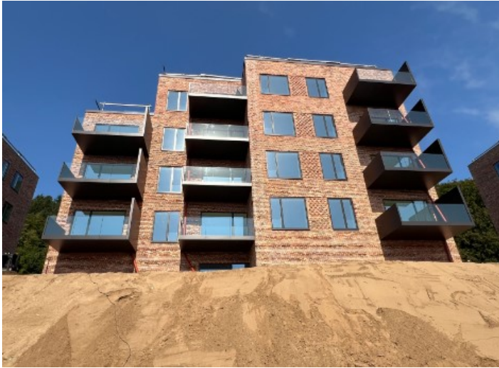
Figur 2: Etageboliger under opførelse - her ses det midterste af de tre punkthuse med etageboliger. Altaner etableret efter bygherres ønske.
